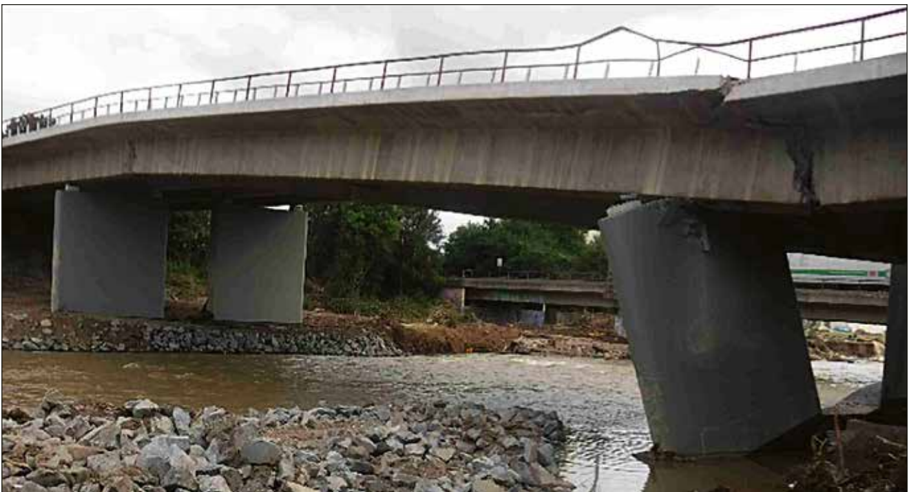
Abbildung 1: Kollabierter Überbau der B 9 – Ahrbrücke Sinzig am 16. Juli 2021
