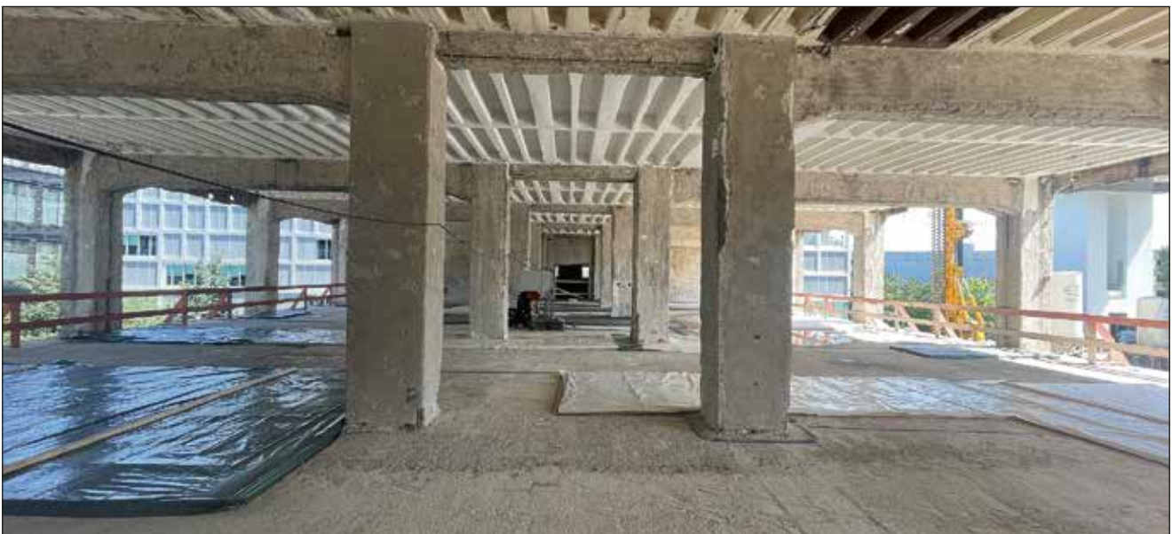
Abbildung 5: Ansicht fertig installierter Extraktionsflächen
