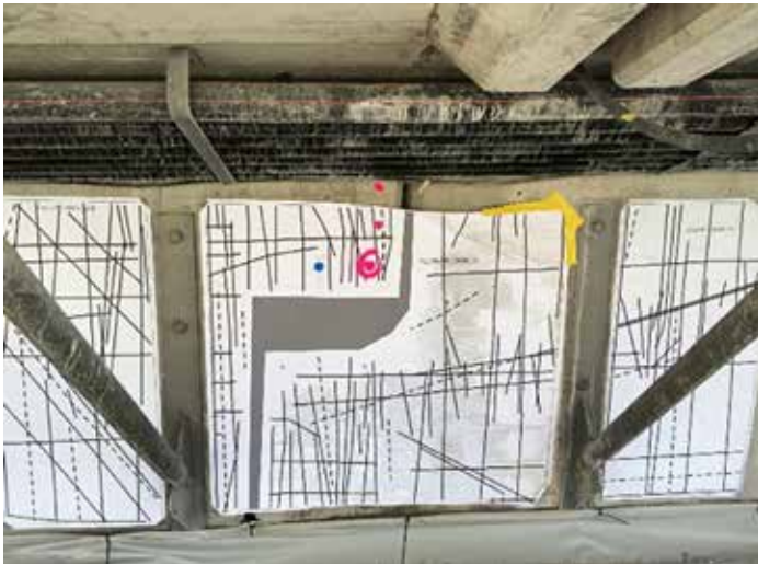
Abbildung 4: aufgeklebte Tapete mit Bewehrungslagen
