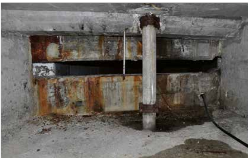
Abbildung 3: Querträger vor der Instandsetzung
