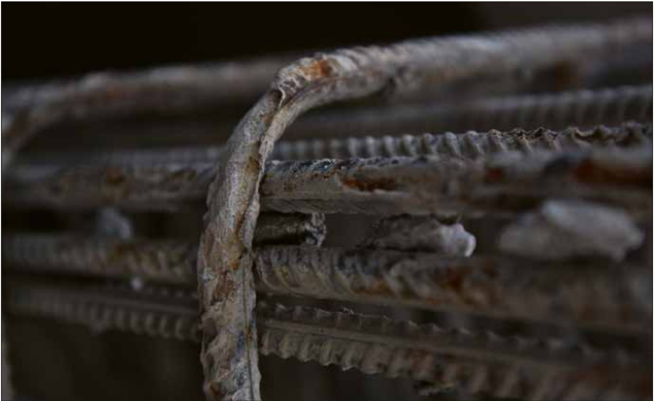
Abbildung 9: Korrosionsschäden an bestehender Bewehrung
